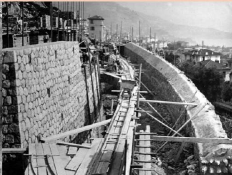
Avenue Hector Otto : travaux de construction de la maison de retraite Hector Otto, avec élargissement de la route.
